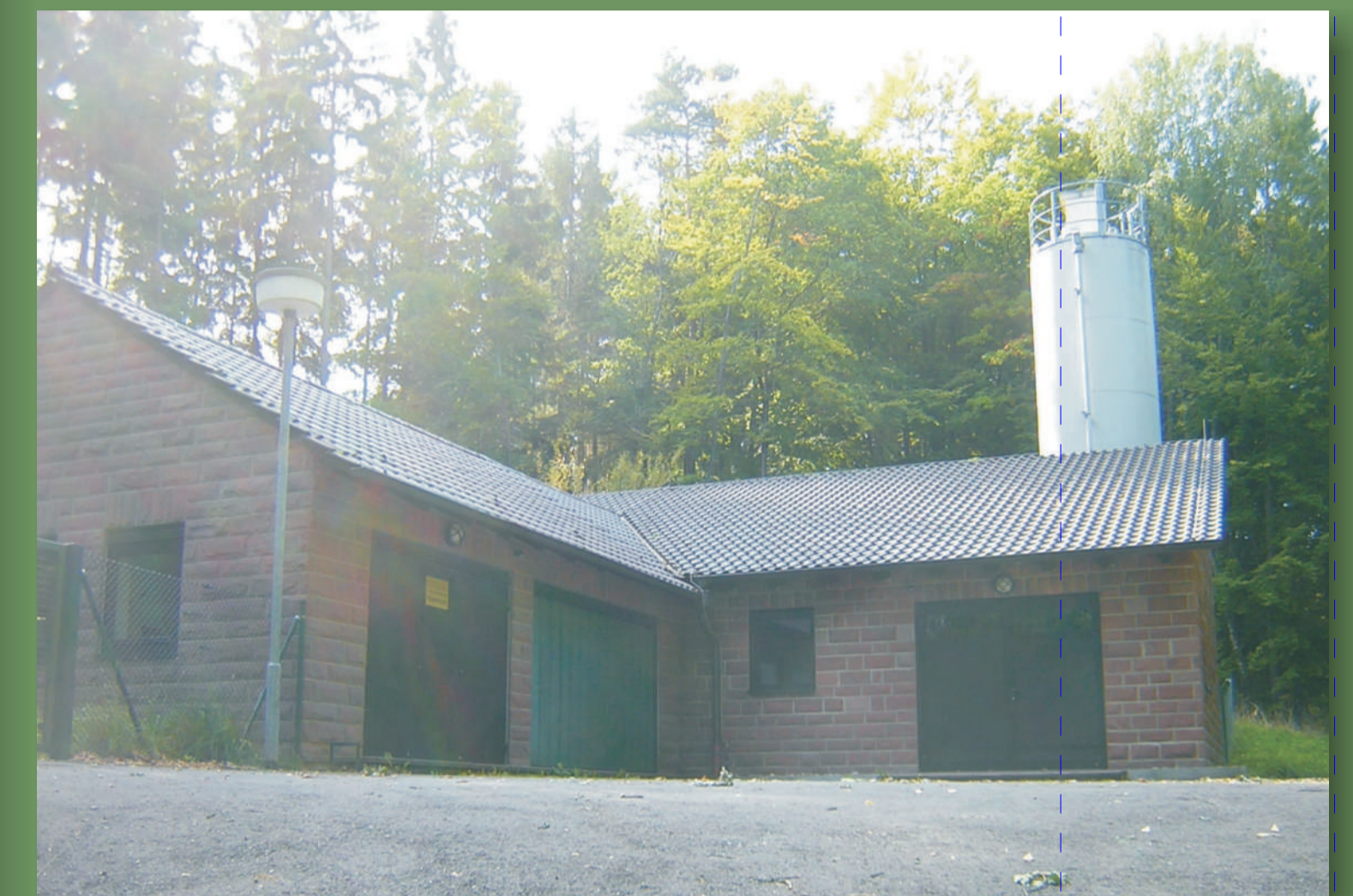
In dieser Aufbereitungsanlage wird das Wasser entsäuert, filtriert (Ultrafiltration) und desinfiziert. Danach wird es über mehrere Hochbehälter an die Verbraucher verteilt.
