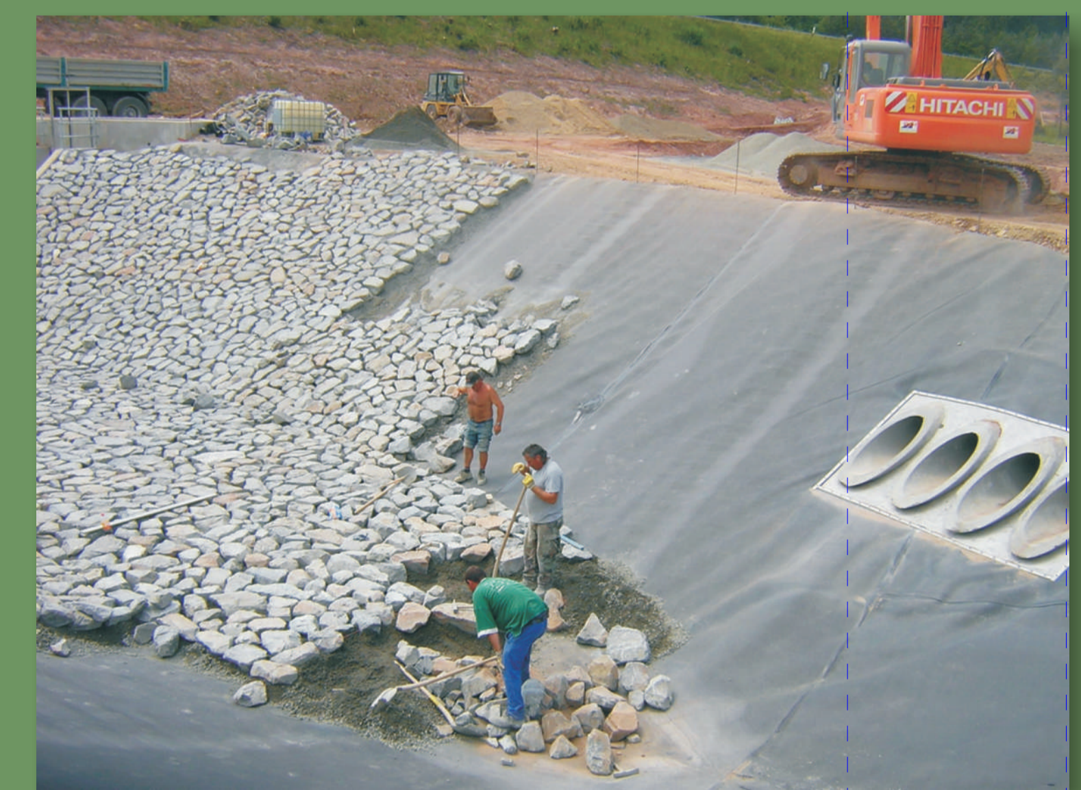
Aufsteigende Rohrleitung als Überlauf zum Filterbecken.
